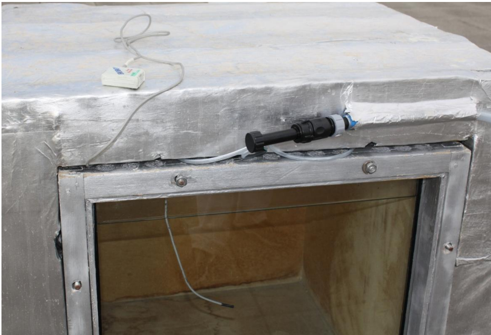
Fig. 7-24. Detalle de la sonda de temperatura del agua junto al sensor y del colector de entrada. Fuente: fotografía de archivo.
